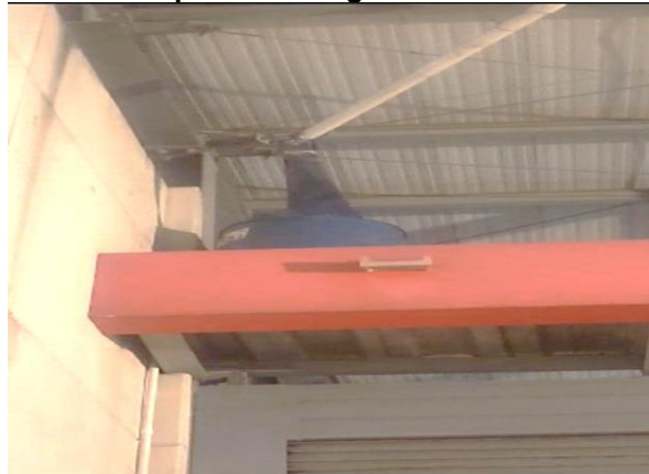
Sistema de captación de aguas lluvias B5 Kennedy
