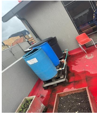
Tanque de almacenamiento de aguas lluvias B10 Marichuela
