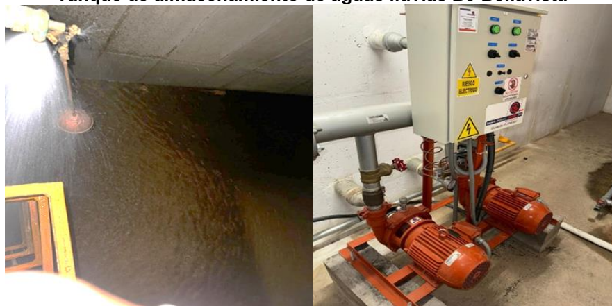
Sistema de captación de aguas lluvias B2 Central
