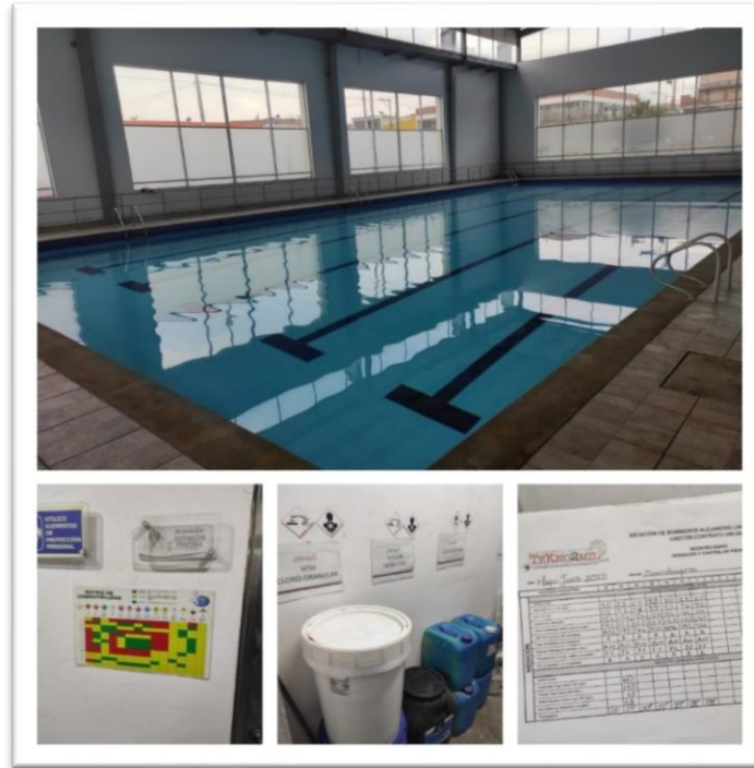
Imagen No. 10 Piscina y cuarto de químicos
